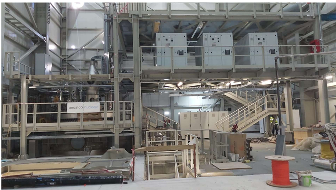
Platforma instalație Athena
